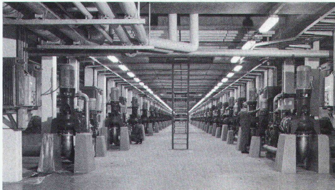
Installation d'épuration Lynetten, Copenhague, 115 pompes TURO.
