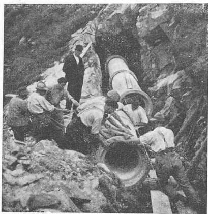
Fig. 2. — Adduction de la Reuse de Saleinaz. Conduite d'amenée en super-béton armé et centrifugé, reliant la prise au dessableur Dufour dans le rocher.
