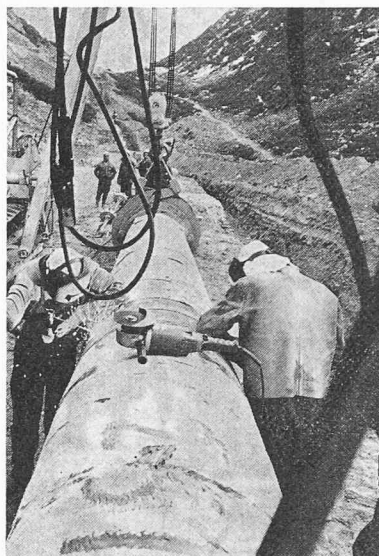
Soudeurs au travail sur un chantier de pose du gazoduc de transit Hollande-Italie, dans le val d'Aegina (VS).
