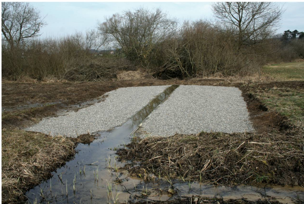
Fig. 8. Aménagement d'un bassin de filtration avec du gravier et une future plantation de roseaux, au sud-est des étangs des Cœudres, à Damphreux, 14.03.09. Photo: Philippe Bassin.
