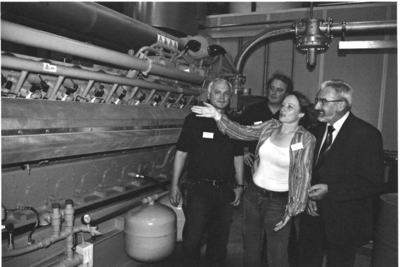
Die Eigentümer Bösch erklären dem Gemeindepräsidenten Ulrich Nef (rechts) das Funktionieren der Biogasanlage.
