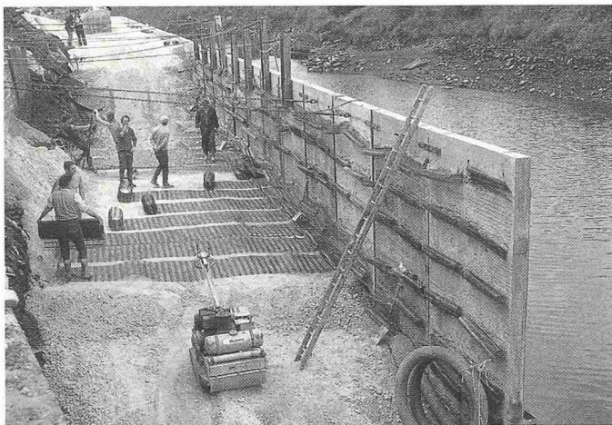
Bauvorgang. Vorfabrizierte Betonelemente mit eingesetzten Geogittern können leicht und zeitsparend eingesetzt werden
