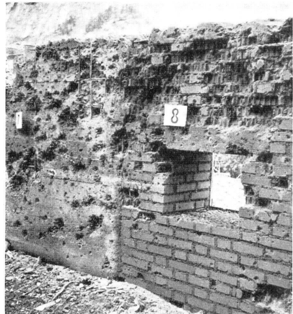
Splitterwirkung auf armierte Betonwand (links) und auf Backsteinmauer (rechts). Die nur 17,5 cm dicke Eisenbetonwand wurde durchschlagen, die Backsteinmauer erhielt Einschläge bis zu Tiefen von 19 cm. Presse Diffusion Lausanne
