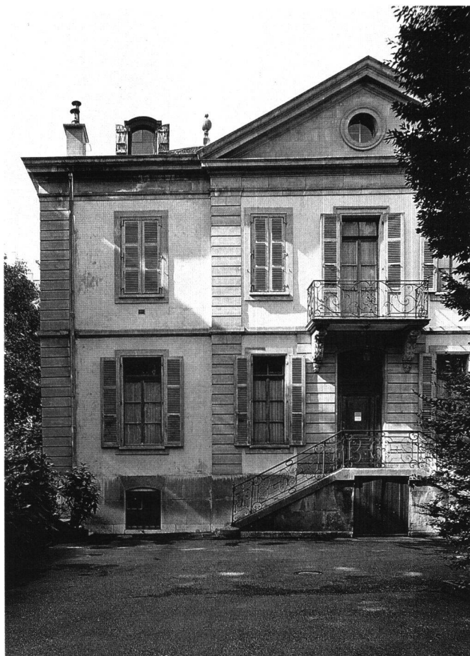
Fig. 5 «Les Délices», Genève. Façade d'entrée sur cour (nord) dans son état de 1989 (avant restauration).
