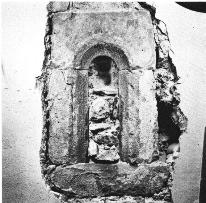
Abb. 13: «Roter Mann» (In Gassen 1): Das romanische Rundbogenfenster aus der Zeit um 1200 ist das älteste bislang bekannte seiner Art im profanen Zürich.
