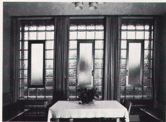
Glasbausteinfenster mit Anticorodal- Drehflügel in Sitzungszimmer.
