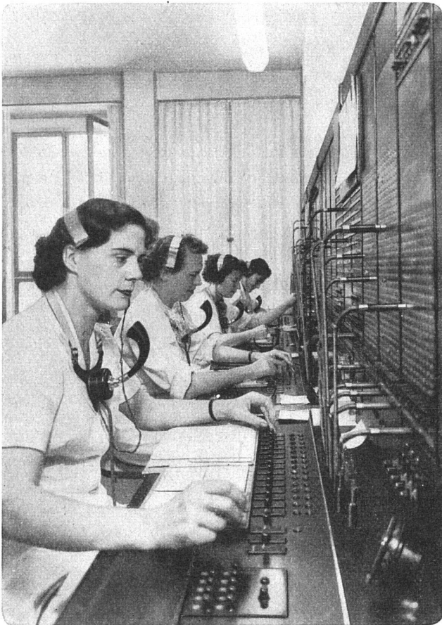
Telephon-Vermittlungseinrichtung im Kantonsspital Zürich für 50 Amtsleitungen und 1200 Teilnehmeranschlüsse, mit Nachtpikettstellen, Direktionsanlagen und Feueralarm-Ausrüstung
