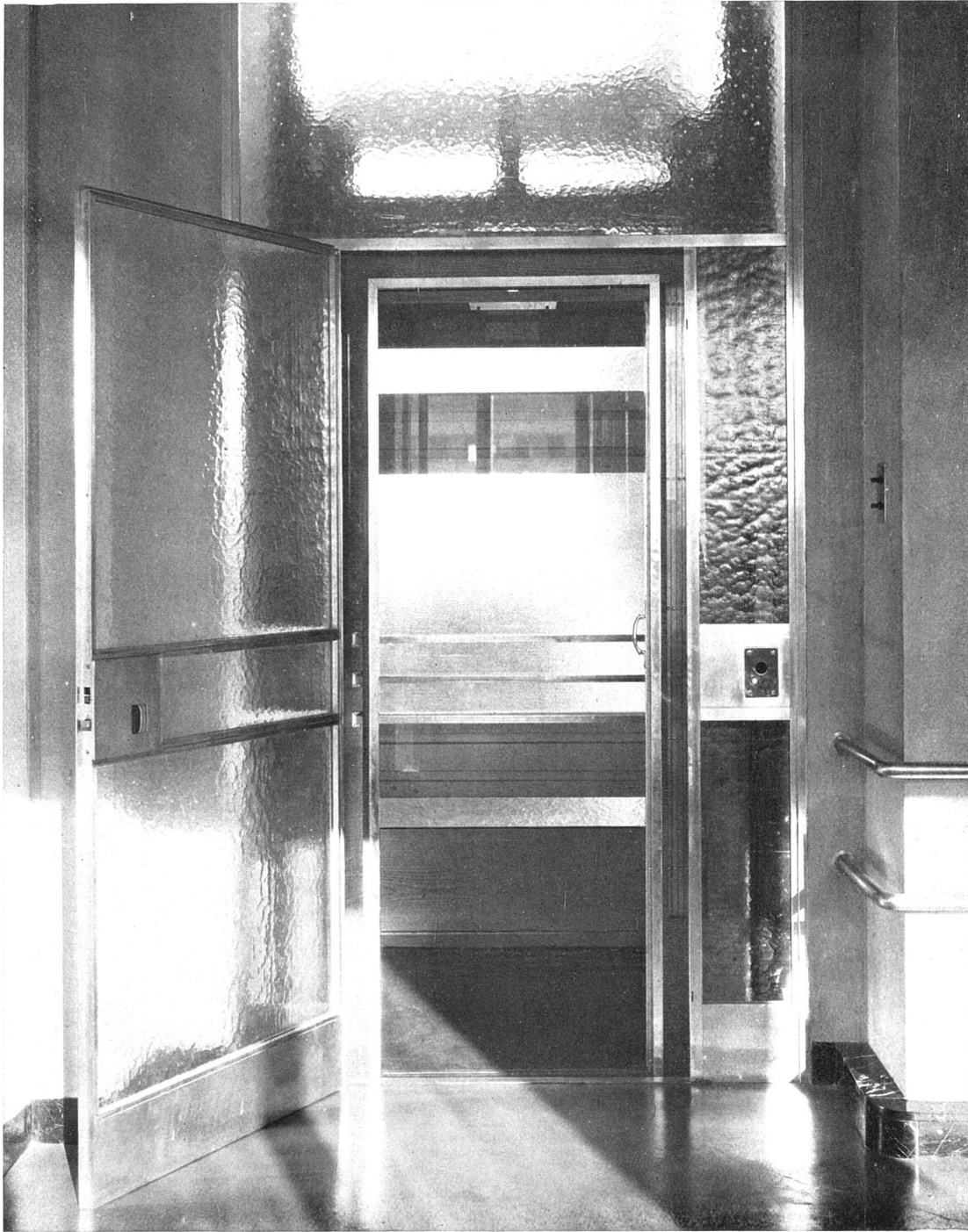
Personenaufzug bei der Treppe in einem Seitenflügel
