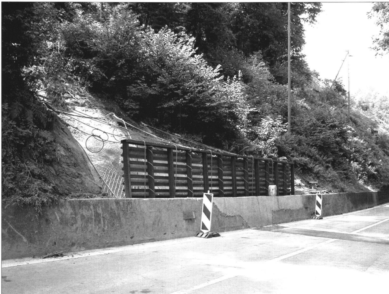
Fig. 9: Flexible und permeable Schutzwände aus Stahlprofilen wurden als Schutzmassnahme zwischen Auffangraum und Strasse versetzt. Die etwa 1 m unter das Strassenniveau reichenden Schutzwände – hier bei Murgang Nr. 1 – sind ähnlich einem Steinschlagschutznetz an Stahlseilen rückverankert.
