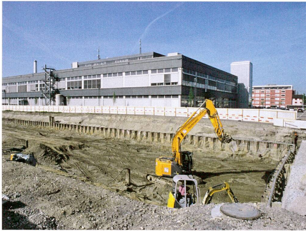
Abb. 8 Zug, Theilerstrasse (Überbauung «Zug Point»). Überblick über die bereits weitgehend fertig ausgehobene Baugrube. Am rechten Bildrand, oberhalb der Spundwand, legt der Zivildienstleistende Rafael Kühne ein Stichprofil an. Die subfossilen Föhren fanden sich im Bereich der Baugrubensohle. Im Hintergrund das Siemens-Gebäude Theilerstrasse 1 und 3. Blick nach Südwesten.
