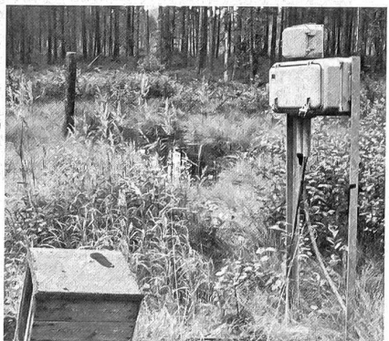
Zum Seismologischen Observatorium gehören auch eine Anzahl aussenstehender Stationen wie beispielsweise diese Schaltdose für den kurzperiodischen Bohrloch-Erdbebenmesser.
