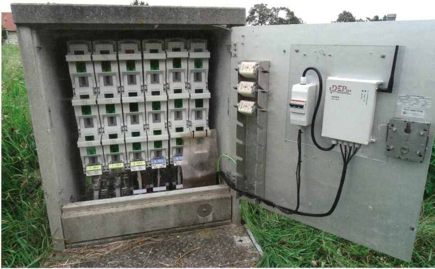
Figure 2 Armoire de distribution avec un module GridEye.
