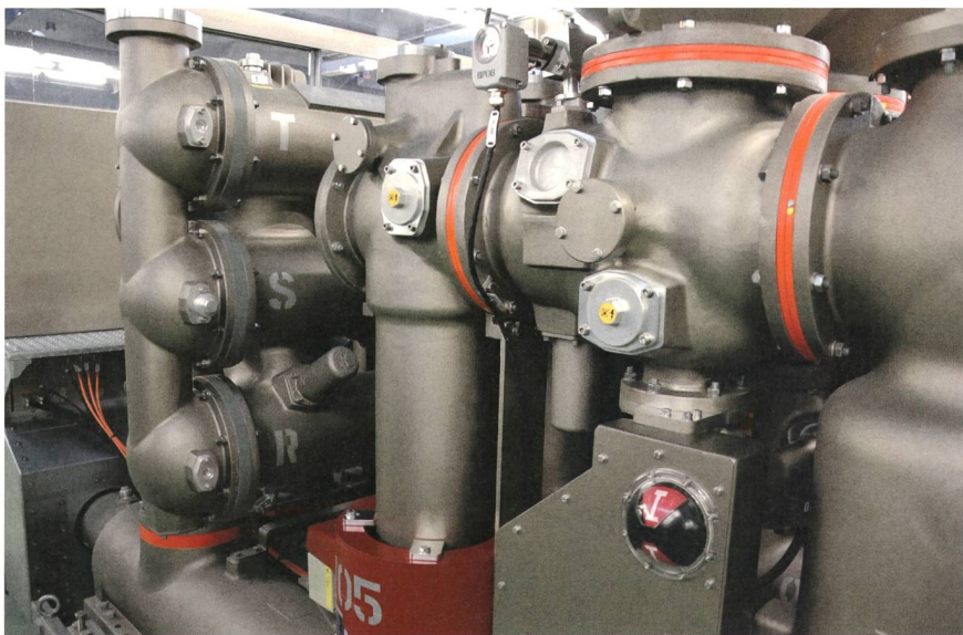
Premiere einer Schaltanlage mit klimafreundlichem Gasgemisch.
