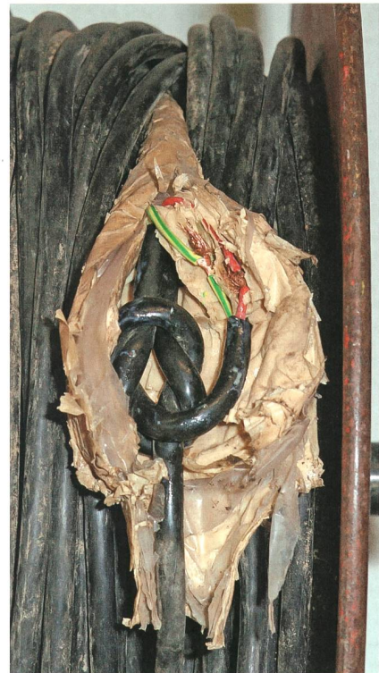
Fehlerhafte Arbeiten an elektrischen Installationen und Geräten durch Laien können tödlich sein – Kabelrolle unter Spannung.
