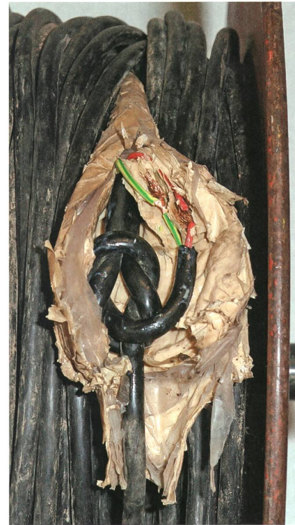
Lavori difettosi su impianti e apparecchi elettrici eseguiti da persone non qualificate possono essere letali – Rotolo di cavo sotto tensione.
