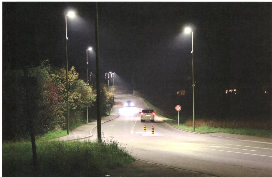
Bild 1 Anlage mit Radarsensoren und LED-Leuchten in Regensdorf.
