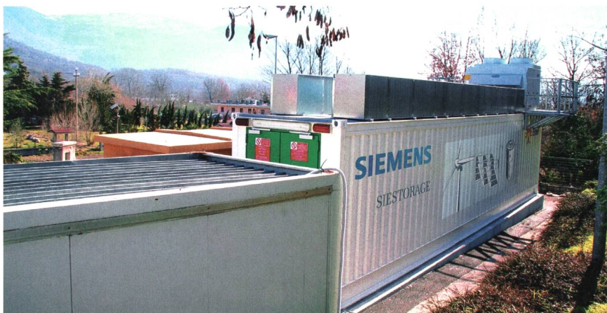
Bild 4 Batteriesystem des Isernia-Projekts in Italien.
