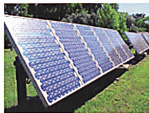
Solarmodule der Anlage in Moura (Portugal).
