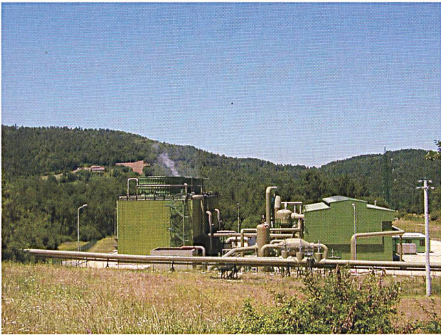
Anlage Travale im Gebiet Larderello.
