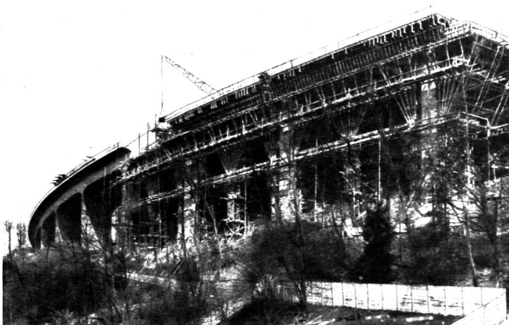
Los 2: Bau des Viaduktes über die Talwegmulde, links fertiger Teil, rechts Gerüste mit Turmdrehkran.
