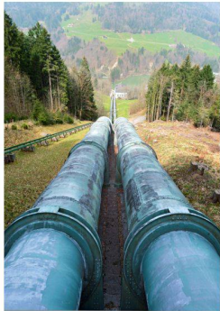
Druckleitung Rempen des Kraftwerks Wägital mit Standseilbahn. Blick von der Apparatekammer zur Zentrale Rempen, dahinter das Ausgleichsbecken der unteren Kraftwerksstufe (Foto: Peter Würmli)
