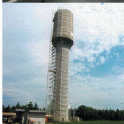
Behälter- und Bäderbau
