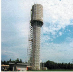
Behälter- und Bäderbau
