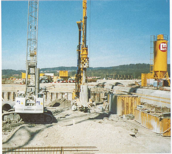
Flughafen Zürich, Dock Midfield heizt und kühlt mit Geostrukturen
