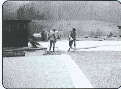
Absaugen von Kies, Sand und Humus ab Flachdach, bei Baustellen und Kellern mit erschwerem Zugang.
