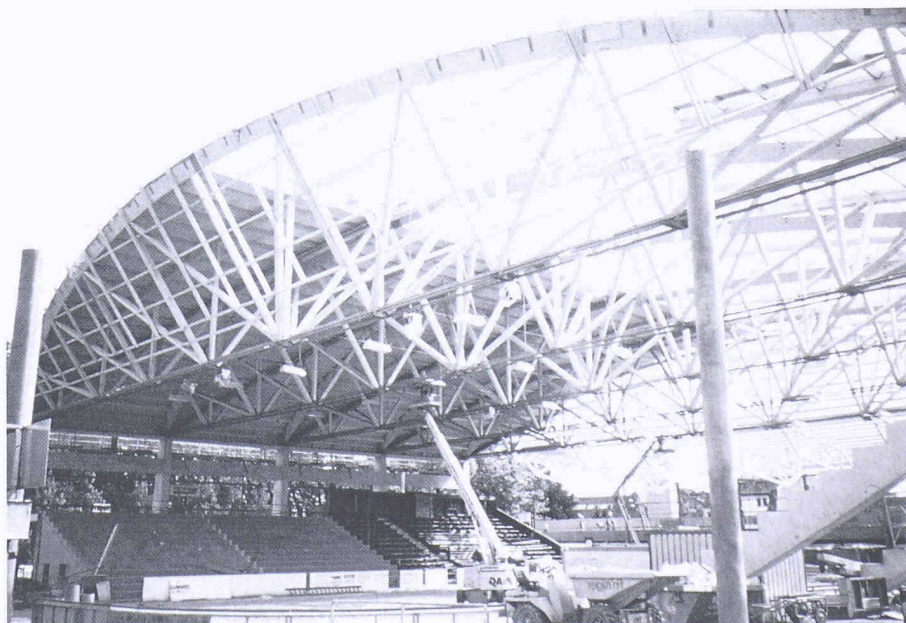
Die Dachkonstruktion aus fünf mächtigen Holzbindern ist teilweise bereits von der Dachhaut bedeckt (Bild: Isover, Lausanne)
