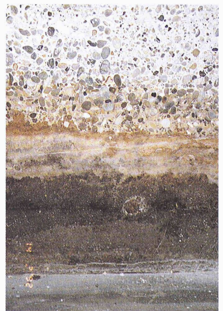
Bild 2. Schadensbild im Ablaufkanal
