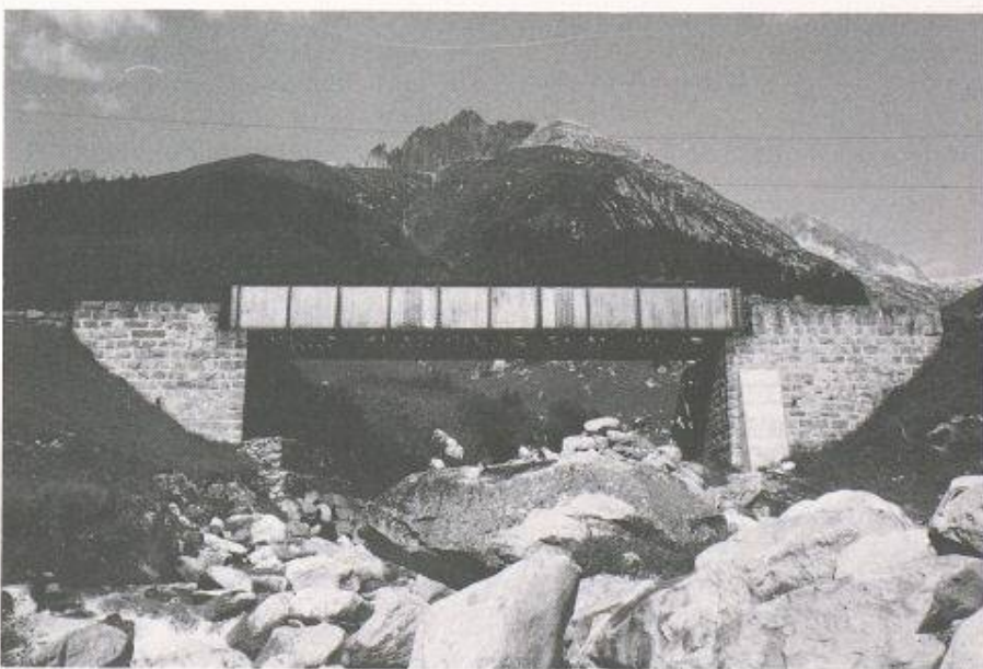
Bild 4. Alte, zu ersetzende Stahlbrücke
