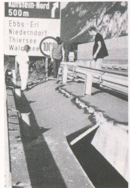
Bild 1. Inntalbrücke bei Kufstein nach dem Schadensfall
