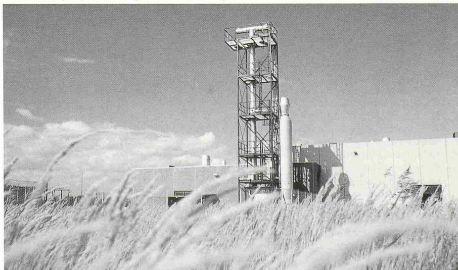
Bild 1. Isopropanolrückgewinnungsanlage für einen Pharmabetrieb
