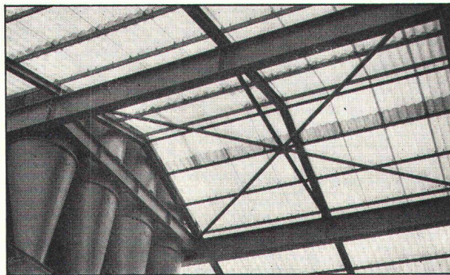
Neomat-Lichtdach auf einer Siloanlage
