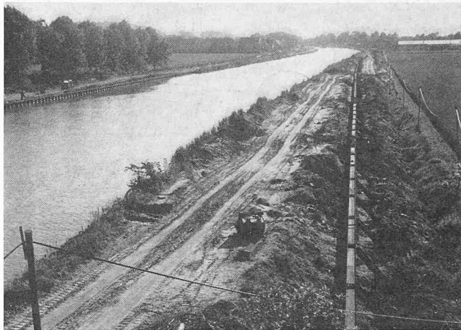
Bild 5. Ausbau des Mittelland-Kanals für das 1350-t-(Europa-) Schiff. Der Boden wasserseitig der Spundwand muss noch gebaggert werden. Für derartig gerade Strecken wurde der Laserstrahl als Rammachse verwendet
