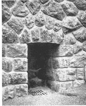
Abb. 7 (Gegenbeispiel). Neue Mauernische. Stichgewölbe ohne ausgeprägte Widerlager wirkt fast wie ein Balken. Ungünstige Verhältnisse der Steingrößen sind dem Gesamteindruck abträglich: die kleinsten Steine sind die am stärksten beanspruchten
