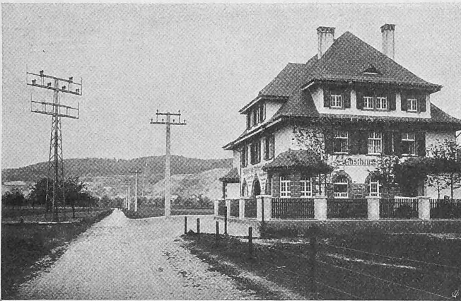
Abb. 72. Abgehende 45 000 Volt-Leitungen beim Kraftwerk Wyhlen. Rechts Eisenbetonmasten der Leitung nach Lörrach, links Gittermast der Strecke nach Schusterinsel.
