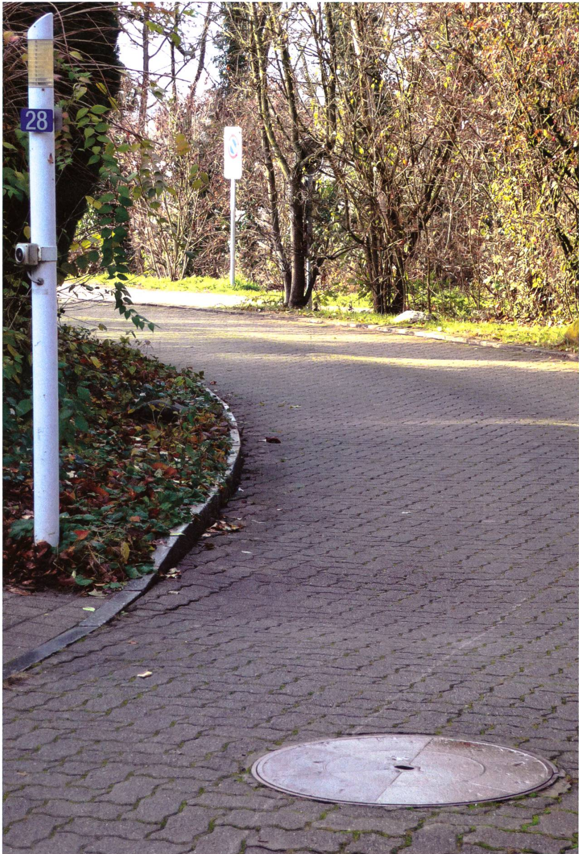
In diesem Schacht, «Alte Saline 28», sind die Soleleitungen der Salinen Rheinfelden und Riburg verbunden.
