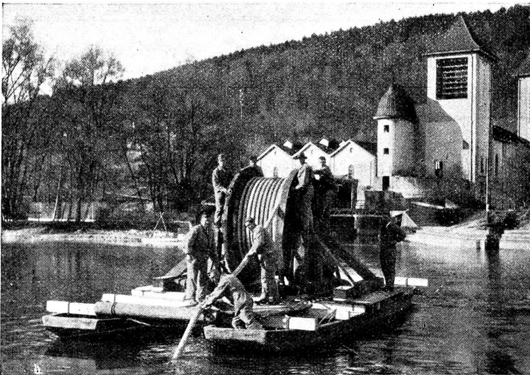
Verlegung eines Hochspannungskabels durch die Aare für das Elektrizitätswerk der Stadt Aarau.
