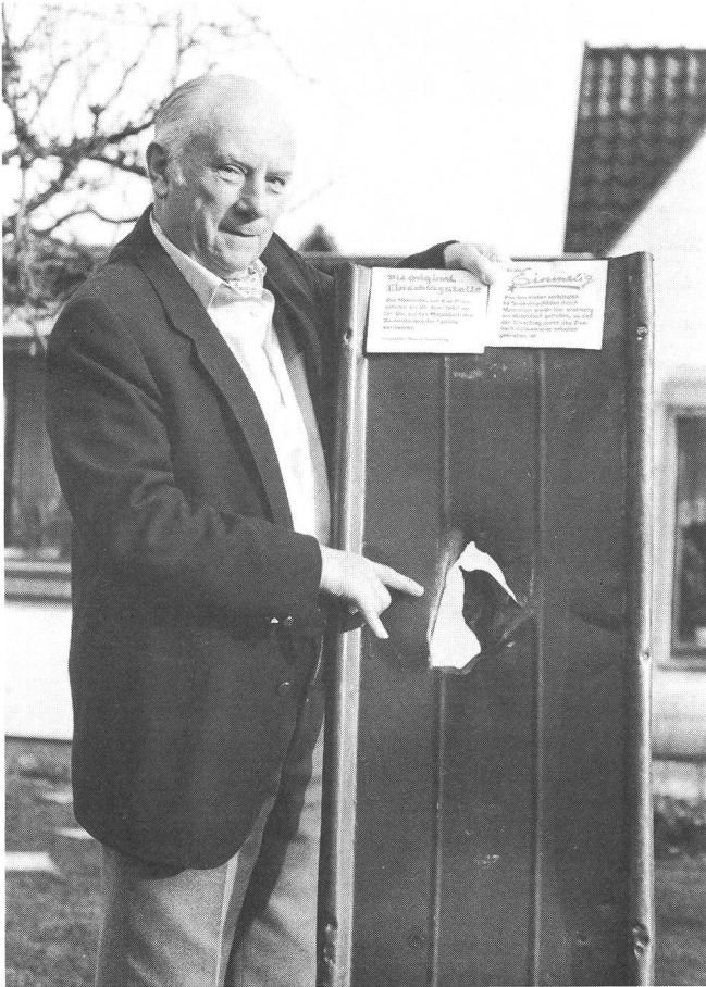
Schäden durch Meteorite: Am 26. April 1962 gegen 13.45 Uhr MEZ schlug der 737.6 Gramm schwere Steinmeteorit von Kiel dieses Loch durch eine Dachbahn aus Blech. Abgesehen von vereinzelten Gebäudetreffern halten sich die Schäden durch Meteorite durchaus in Grenzen. (Sammlung: ARNO LENGOWSKI, Schleswig).
