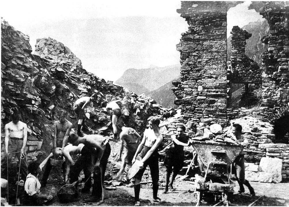
1: Die Freilegungsarbeiten von 1925/26 durch die «Pro Campagna» unter der Leitung von Eugen Probst.
