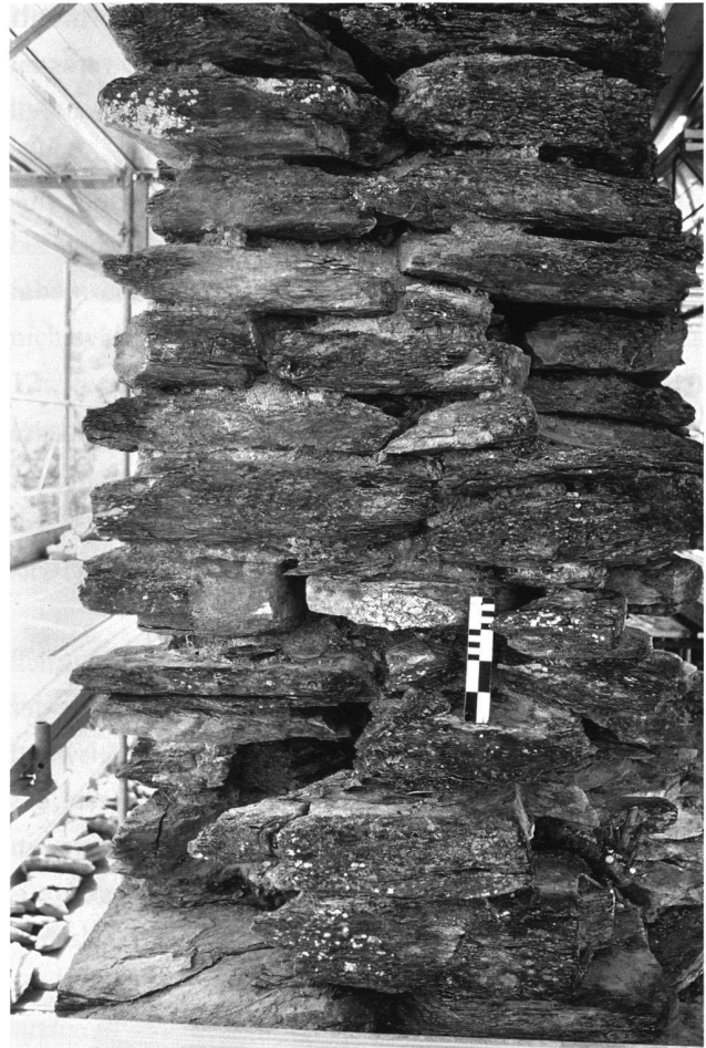
4: Turm, Eckverband M1/M2. Stark ausgewaschenes Mauerwerk der Aufstockung oberhalb des Balkenlochs 2.7, von ONO.
