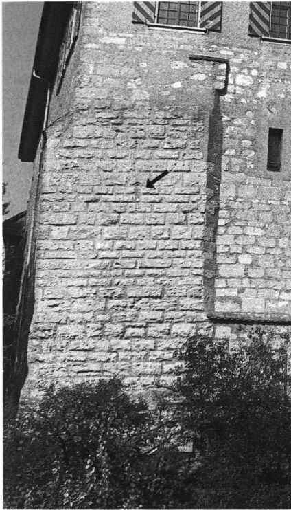
25: Ausschnitt der Südostfassade des Südwestbaus mit dem Kernbau Süd (32), der eine zugemauerte Rundbogenluzide (Pfeil) enthält. Einige der obersten Buckelquader zeigen Zangenlöcher. Der Kernbau Süd ist von der 1472 erneuerten Wand des «Ritterhauses» umgeben.
