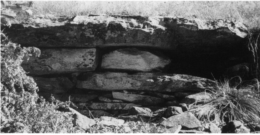
20: Der Caslasc von Grumo (Gde. Chironico), Ansicht der Westmauer. Auch hier besteht das Mauerwerk aus grossen, sorgfältig geschichteten Steinplatten.
