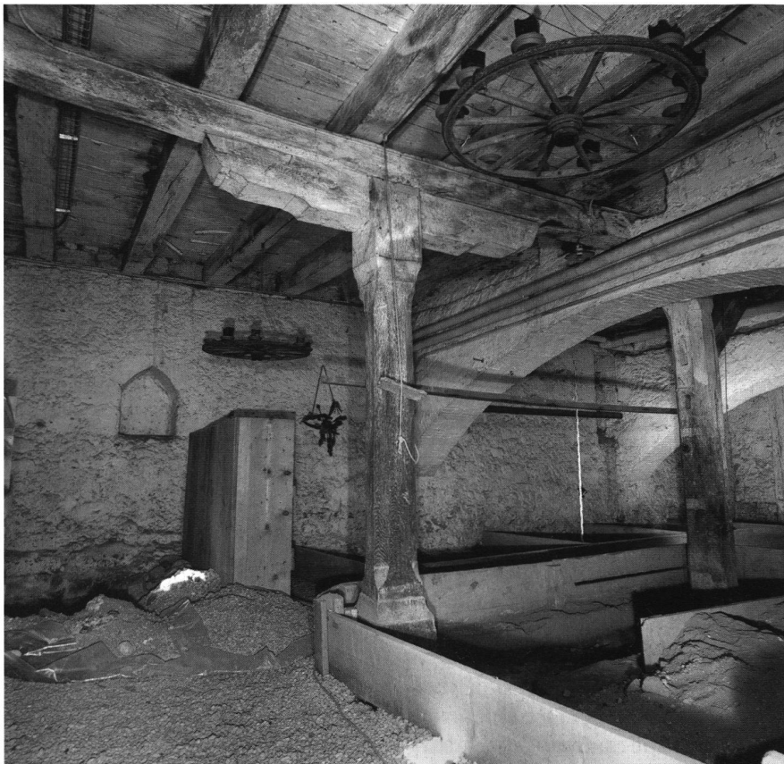
8: Der Keller des Saalgeschossbaues. Sichtbar ist die originale Geschossbalkenlage mit zugehörigem Unterzug und Stütze im Hintergrund. Die Stütze im Vordergrund ist nachträglich, ebenso die beiden Schwibbögen aus Backstein. Blick nach Südwesten.
