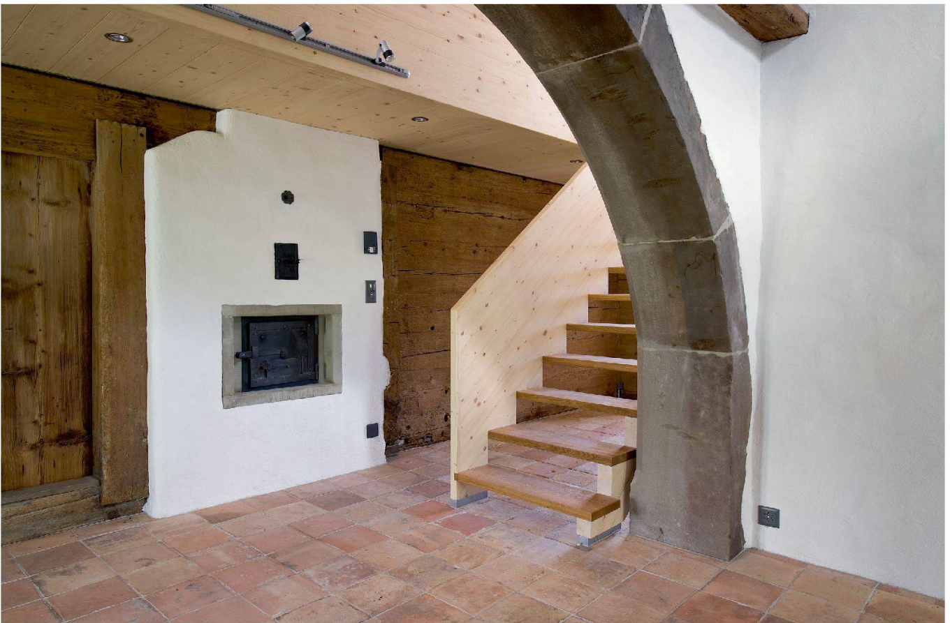
Abb. 5: Schwyz, Haus Engiberg 8, Seewen (Köplihaus). Im Bereich der alten Küche und des Treppenhauses sind die unterschiedlichen Konstruktionsarten des Hauses gut ablesbar.
