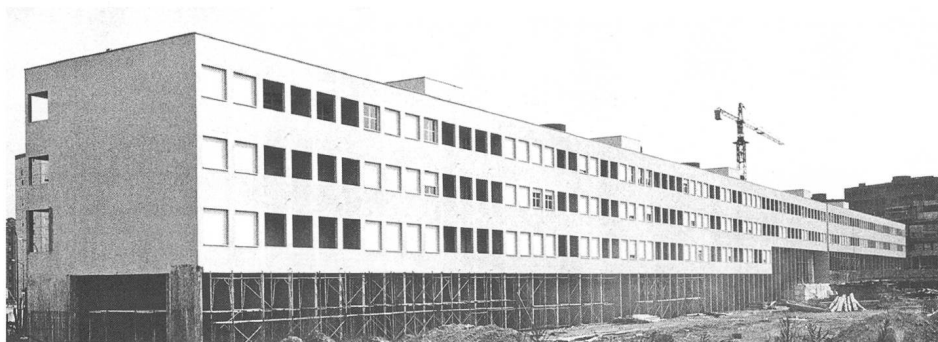
A. Rossi, immeuble de logements dans le quartier «Gallaratese 2», Milan, 1969-1974, photographie du chantier.
