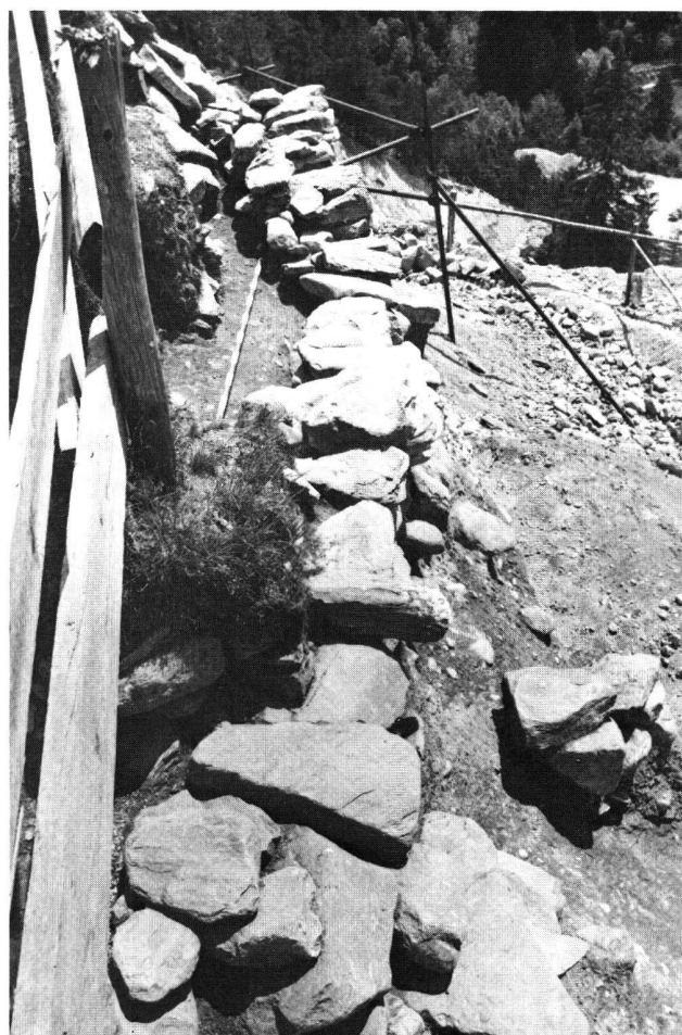
Abb. 41. Scharans, Spundas, GR. 1978. Feld 1/2, Süderweiterung, nach dem 2. Abstich. Trockenmauerkonstruktion M 1. (Foto AD GR.)
