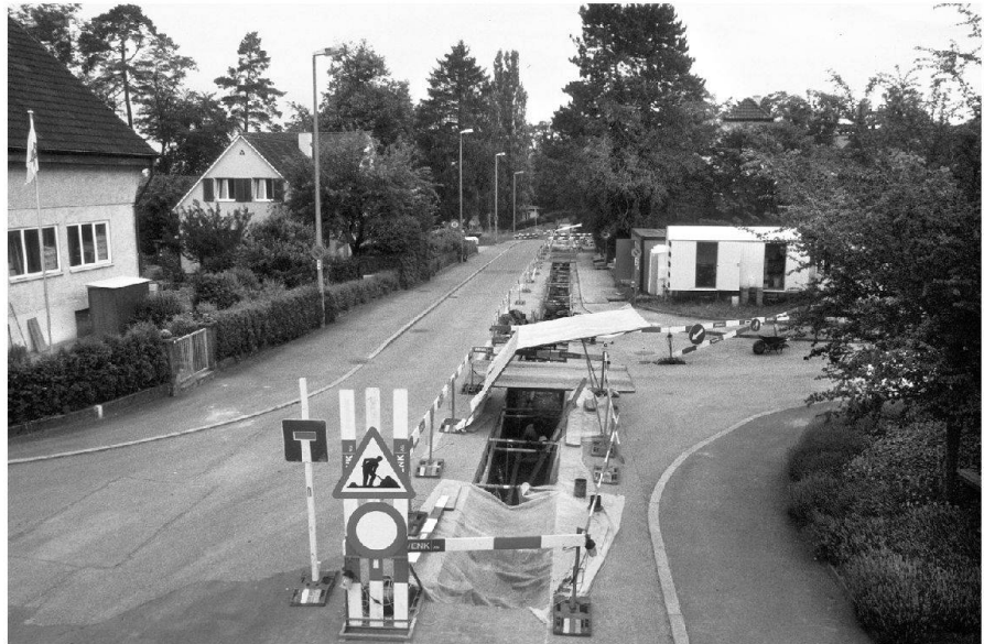
Abb. 5: Augst BL, Wasserleitung Giebenacherstrasse (Grabung 2003.51). Der ausgehobene Graben der zweiten Etappe, zwischen der Einmündung des Basilicawegs und der Kreuzung mit der Curiastrasse (von rechts) und der Thermenstrasse (von links). Von Südosten.
