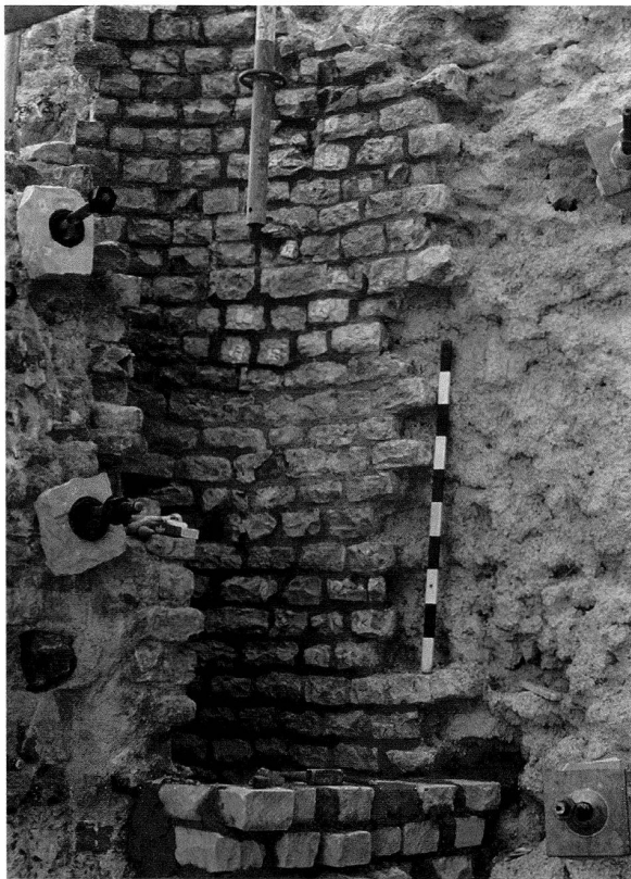
Abb. 38: Augst, Theatersanierung (Grabung 2002.55). Sanierungsarbeiten am Mittelvomitorium. Feinsanierung an den originalen Muschelkalk-Mauerschalen der Entlastungsbögen. Beschädigte Handquader werden, soweit möglich, mit speziellem Restauriermörtel geklebt oder ergänzt und «weicherer» Mörtel auf Kalkbasis ersetzt die entfernten harten Zementfugen der älteren Restaurierungen. Sämtliche geklebten Handquader werden für die Dauer der Arbeiten markiert (vgl. Mauerschale in oberer Bildhälfte), damit die Informationen am Schluss auf die Pläne der Restaurierungsdokumentation übertragen werden können.
