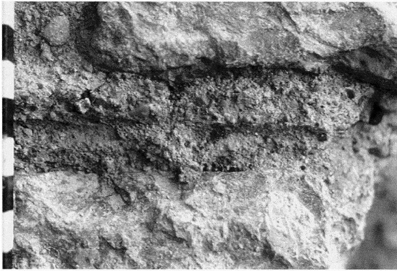
Abb. 5: Augst, Theatersanierung (Grabung 2002.55). Blendbogen der südlichen Eingangshalle. Detail von Abb. 4. Rest von halbkreisförmig eingeritztem, rot bemaltem Fugenstrich in situ. Darüber anhaftender Mauermörtel einer jüngeren Bauphase.
