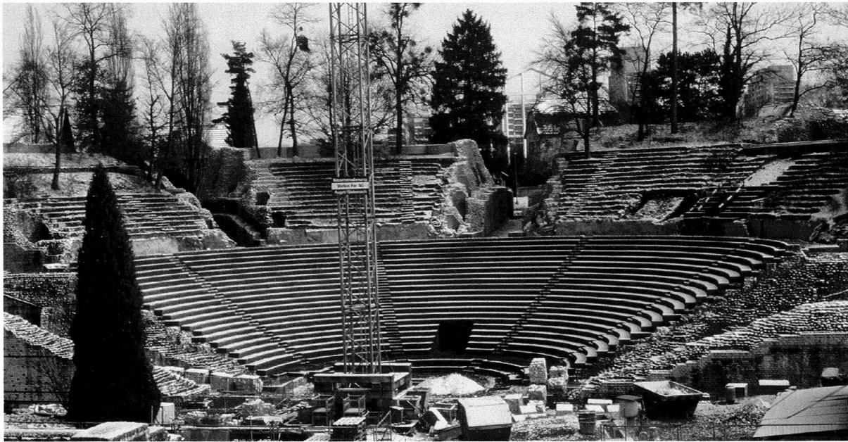
Abb. 34: Augst, Theatersanierung (Grabung 2002.55). Fertig gestellte Rekonstruktion der Sitzstufen im ersten Rang. Gut erkennbar die vier radialen Treppeläufe und die zentral gelegene Nische im Anschluss an den Prohedrie-Umgang.
